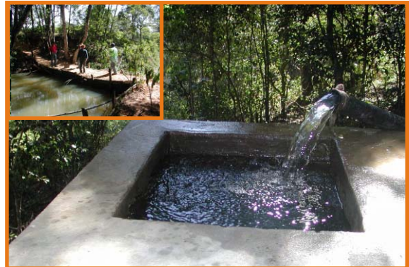
El agua pasa por gravedad de la presa de derivación a una pila de sedimentación.
