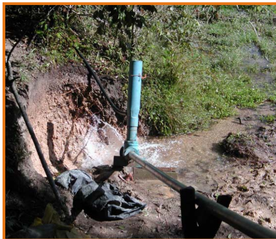
De la pila de sedimentación al ariete hidráulico.
